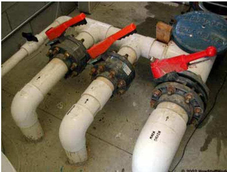
Canos do dreno principal, escumadeira e portas a vácuo levam ao sistema de bombeamento
